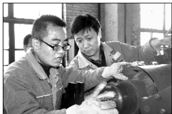
检修分厂电修车间以三岗培训为契机,通过师徒、结对子形式,在干中学,在学中干,不断提升服务氧化铝生产的水平。图为车间主管和一线员工采用手工方式,精心维修焙烧炉风机电动机轴。 摄影报道 裴晓云 张安泽
